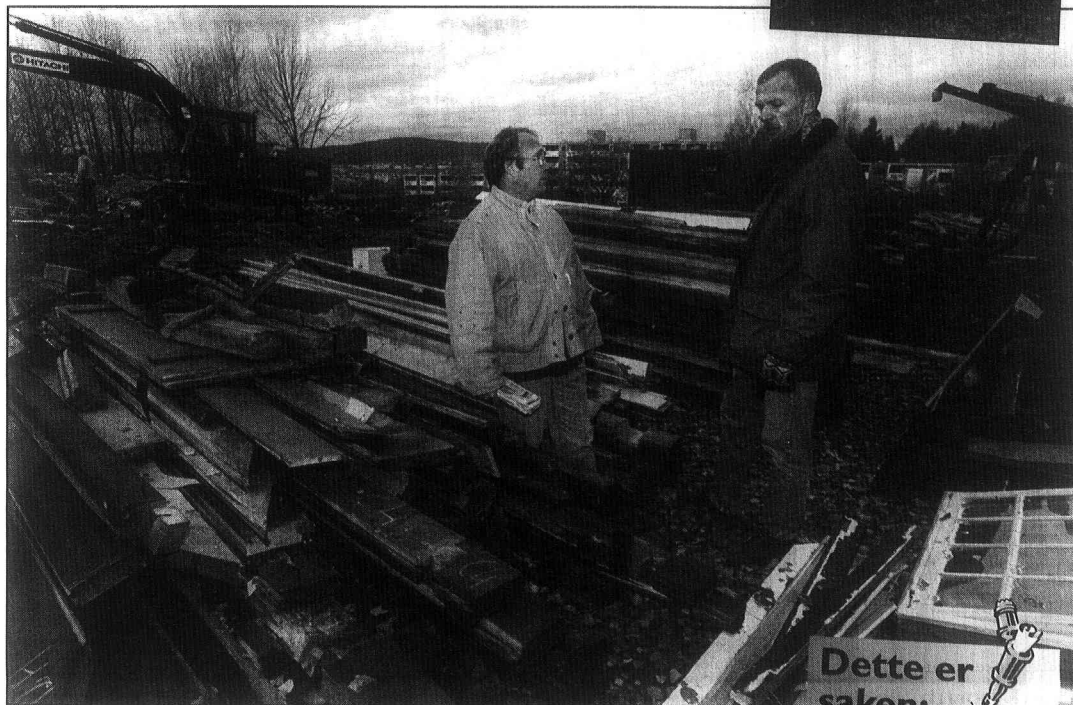
SOLGT: Tomten på Lindeberg der familien Fagerholt drev gårdsdrift er solgt. All bebyggelsen er revet, inkludert et flott stabbur. Nå skal ti rekkehus reises på tomta. Stabburet er plukket ned og ligger fortsatt i biter. - Utrolig at bydelen ikke er villig til å ta vare på stabburet, mener Ben Borgen (t.v.) og nabo Knut Servoll.
